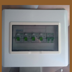
Installation électrique supplémentaire
